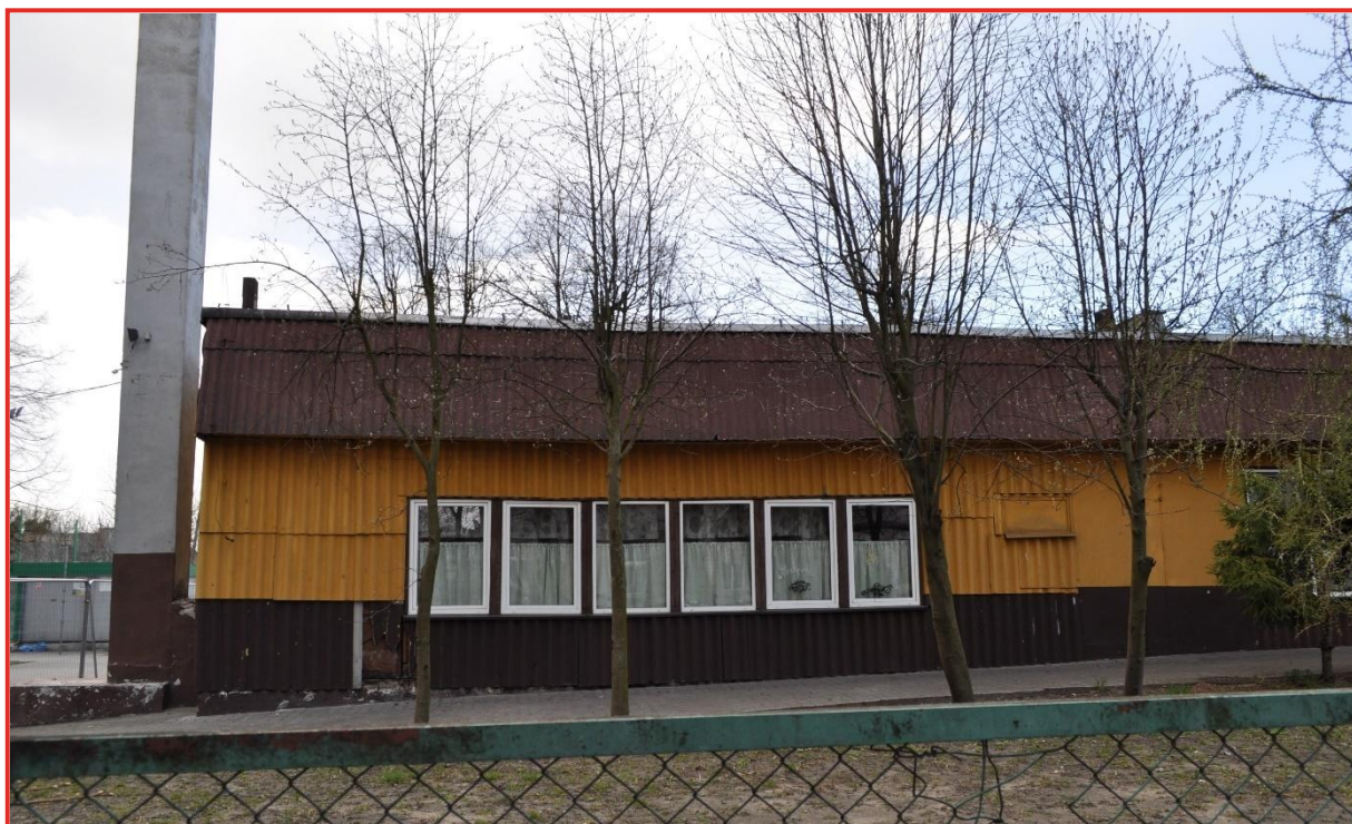
Rysunek 12. Budynek świetlicy i stołówki pokryty azbestem, ul. Kolejowa.
