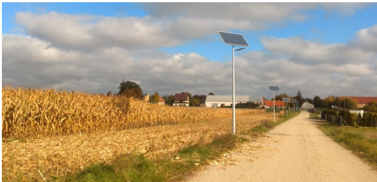
Rysunek 13 Dostawa i montaż drogowych lamp solarnych na terenie Miasta i Gminy Bierutów
