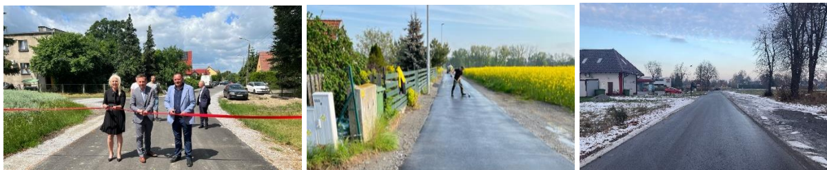
Rysunek 12 Remont dróg gminnych w Gorzesławiu, Karwińcu i Bierutowie przy ul. Spacerowej
